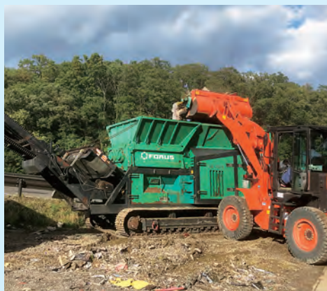
▲二軸粗破碎機の導入 (令和元年11月1日)
